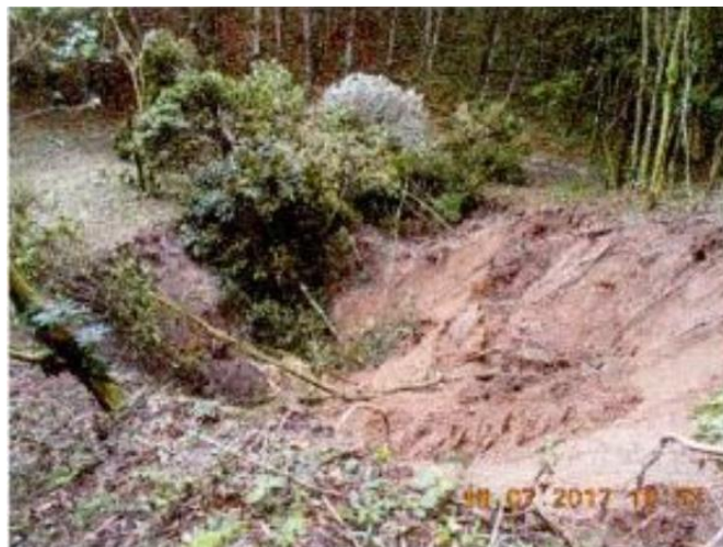
Fotografía de subsidencia en el techo del túnel Buenavista. Fuente: Interventoría Metroandina.
