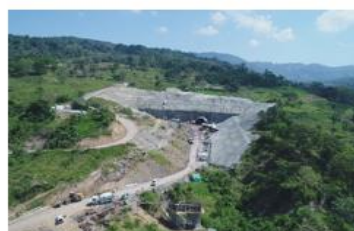
UF5 Portal de Entrada La Sorda
