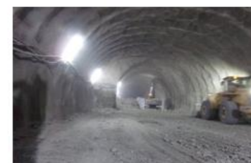
UF5 Portal de Entrada La Sorda
