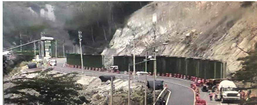
Avance de construcción de tablestacado K58+000 el 14 de marzo de 2020. Fuente: Concesionario
