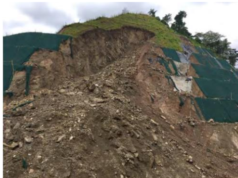
Inestabilidad de talud UF3.1 Fuente: Informe No. 13 Arup (el “Ingeniero Independiente”)
