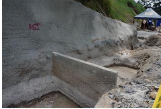
Sistema temporal de tratamiento de aguas de infiltración. Reporte del Ingeniero Independiente. Julio 2017
