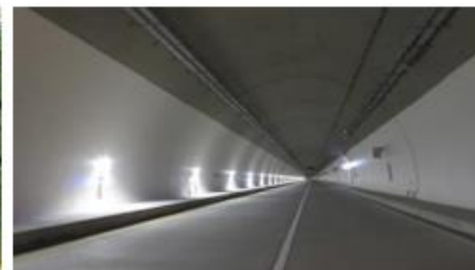
Túnel 5. Pintura de recubrimiento
