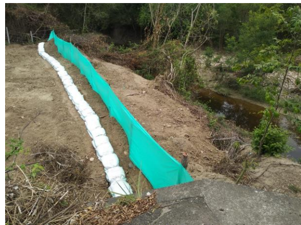
Fotografía 4. Trinchos con barrera en sacos sintéticos en el río Anchique, para esta ingeniería independiente el uso de sacos sintéticos se debe reemplazar por sacos de fique.
