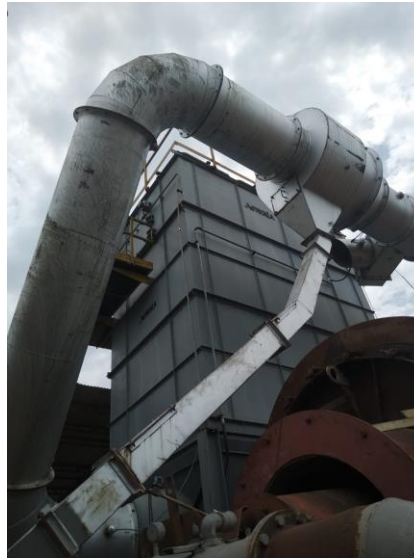
Fotografía 5. Se observan filtro de mangas y ciclón de la planta de asfalto del campamento Saldaña.
